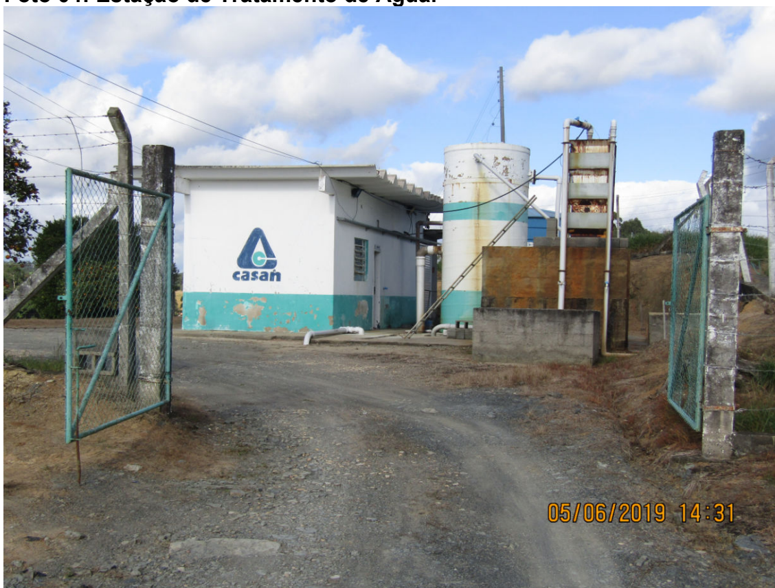
Foto 04: Estação de Tratamento de Água.
