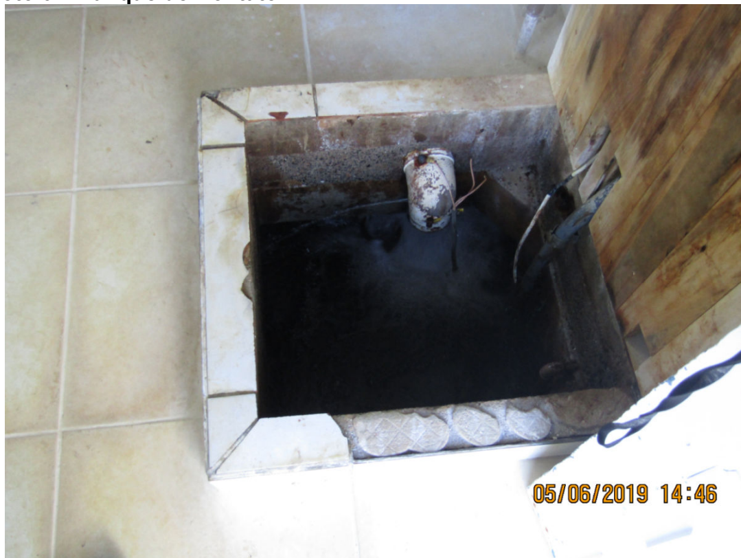
Foto 07: Tanque de Contato.
