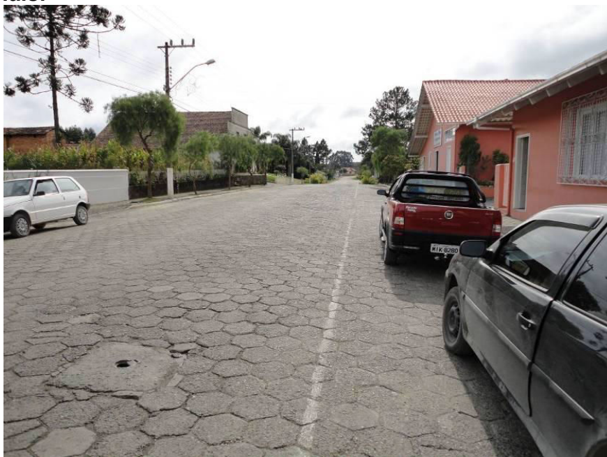
Foto 22: Rede de Drenagem Pluvial – Sistema de Coleta das Águas Superficiais.
